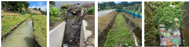
(a) (b) (c) (d) Gambar 6. a) Saluran yang selalu tergenang air; b) Saluran yang dibangun tidak menerus; c) Saluran yang mengalami pendangkalan; d) Saluran tersumbat akibat sampah
